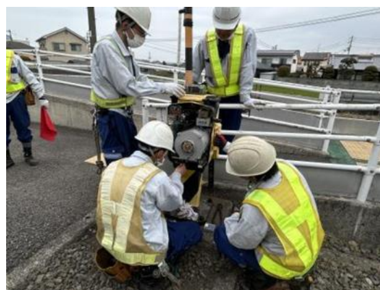
【電路】 遮断機取替訓練
