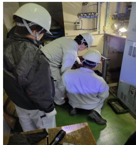
【電気】緊急点検訓練
