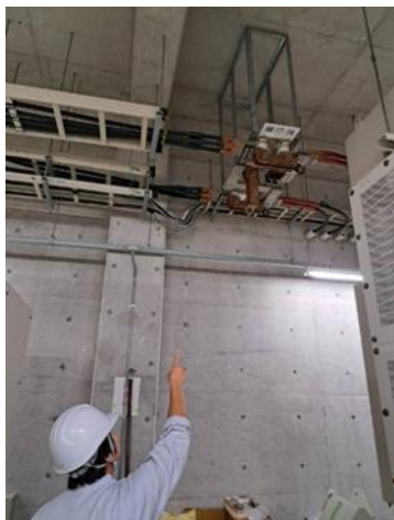
【電気】各変電所の巡視
