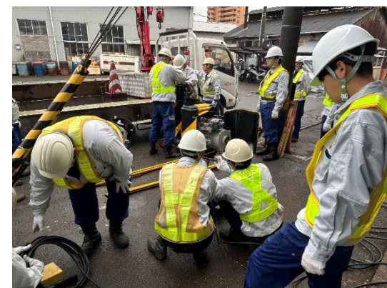
【電路】遮断機取り扱い訓練
