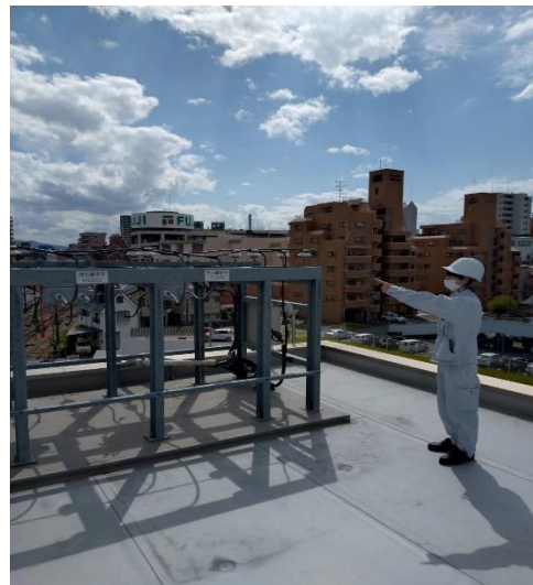
【電気】各変電所の巡視
