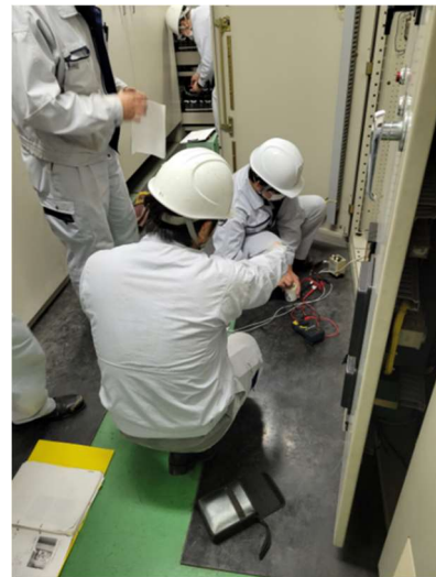
変電所設備の保護継電動作による緊急点検訓練
