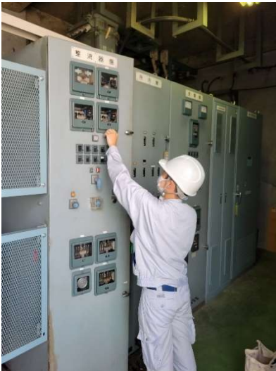
電気係員による保護継電器の測定訓練
