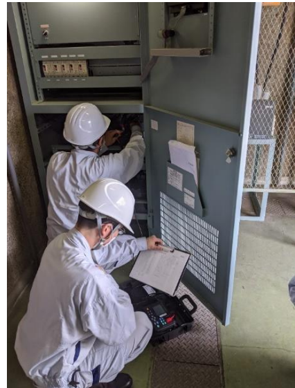
蓄電池異常が発生した場合の点検・処置訓練
