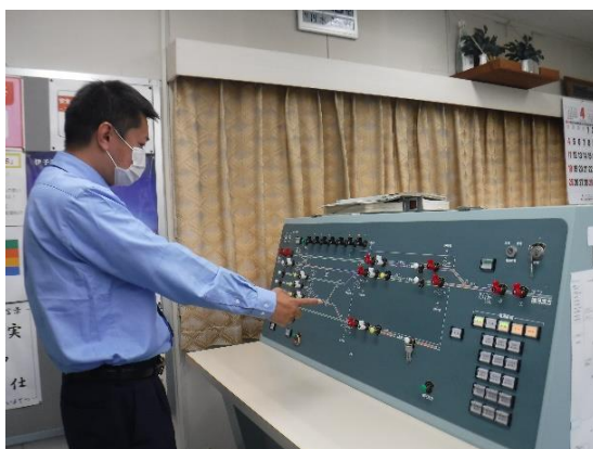
連動盤取扱い訓練
