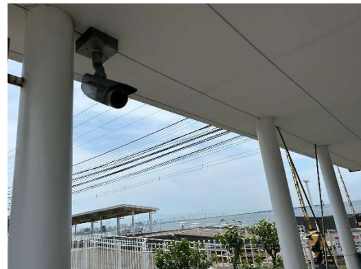
全駅に設置している防犯カメラ
