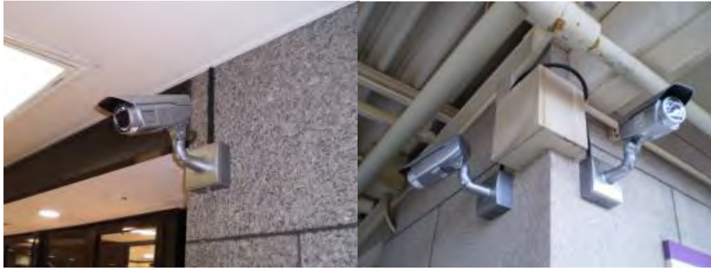
駅構内に設置の防犯カメラ
